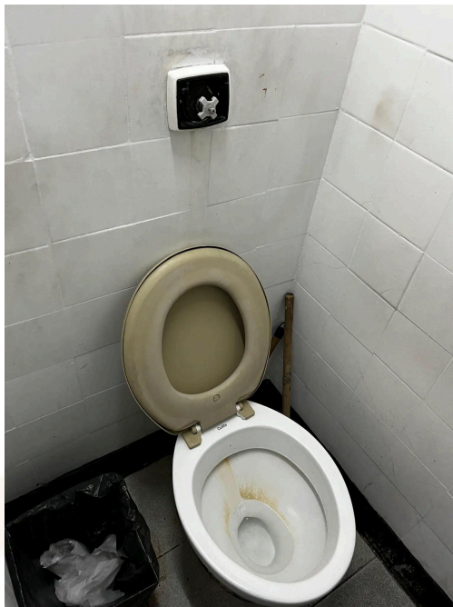
Foto 5: Vaso sanitário com descarga inoperante (botão quebrado/ausente).
