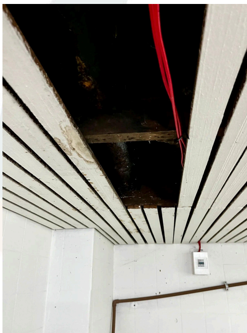
Foto 2: Teto danificado, com fiação exposta e sinais de infiltração.
