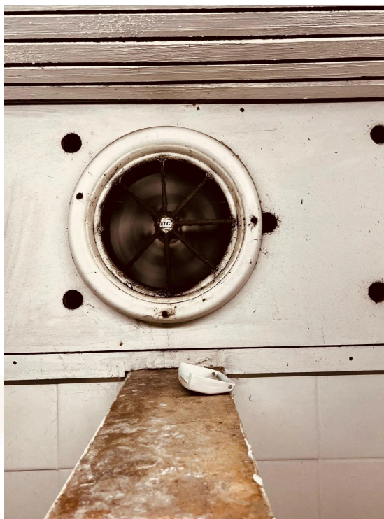
Foto 1: Exaustor com acúmulo de sujeira e poeira.
