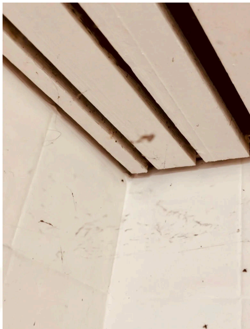
Foto 3: Presença de teias de aranha e sujeira nas paredes e teto.
